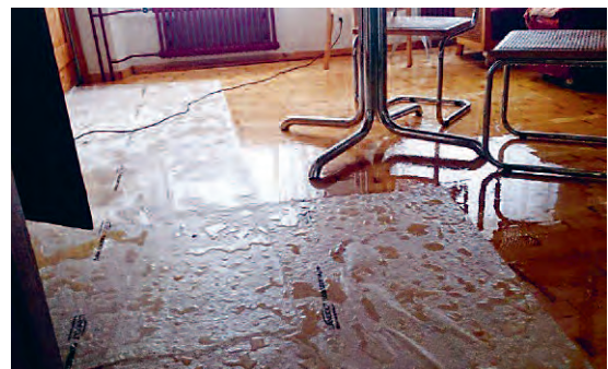
Leitungsbrüche können teure Wasserschäden verursachen
