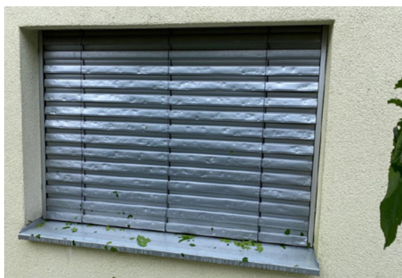
Massive Hagelschäden an Storen
