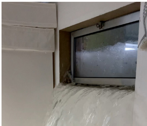
Eindringen von Hochwasser in einen Kellerraum
