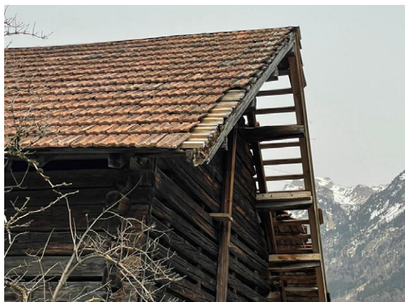
Sturmschäden an einem Stall im Däniberg, Thon
