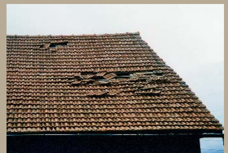
Schäden durch meteorologische Naturgefahren nehmen zu.
