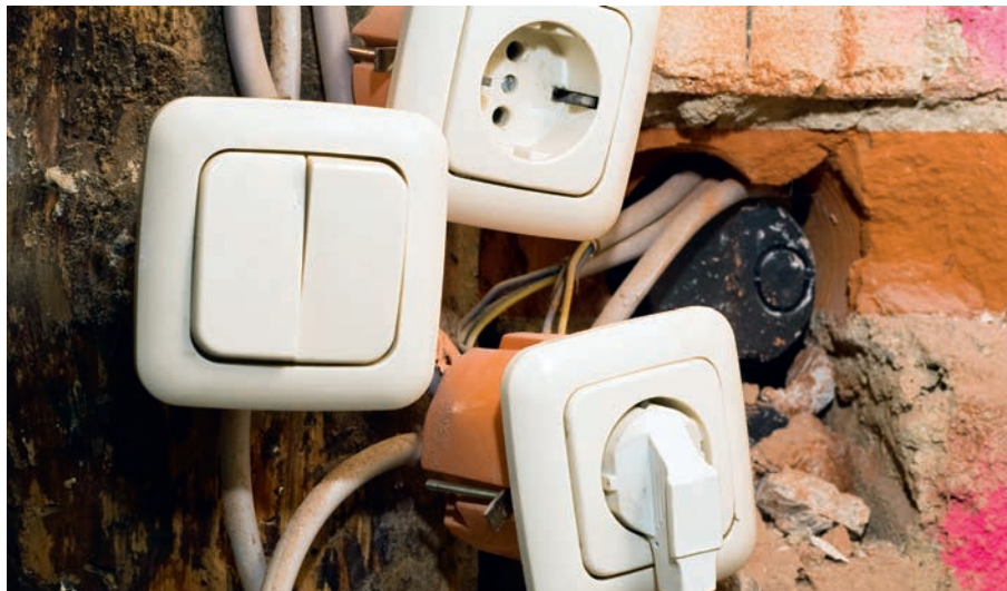
Mangelhafte Installationen können schnell brandgefährlich werden
